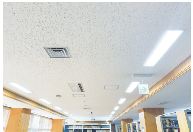
中央図書館西館等 (LED照明)
