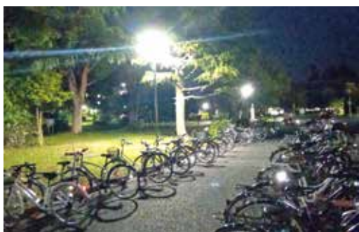
外灯（LED照明）
