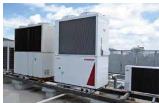
農学部（高効率空調設備）
