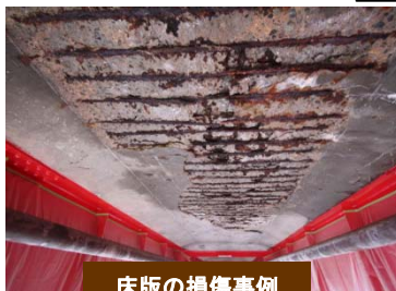
床版の損傷事例
