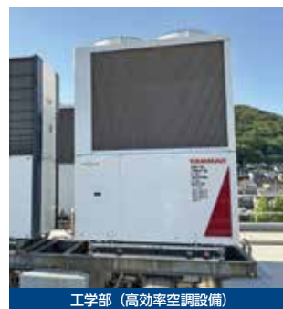
工学部（高効率空調設備）
