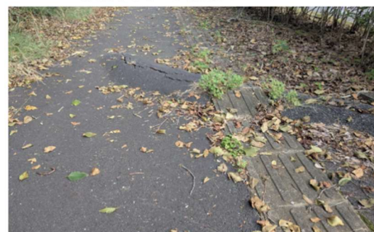
舗装の持ち上がり(走行時の障害)
