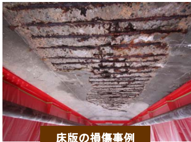
床版の損傷事例
