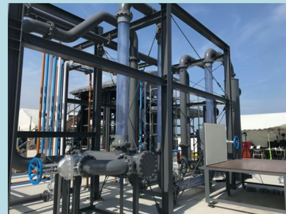
プラントの日常点検
